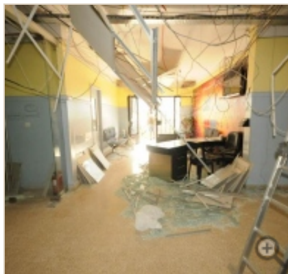
DAS ZERSTÖRTE LIFE CENTER NACH DER EXPLOSION
